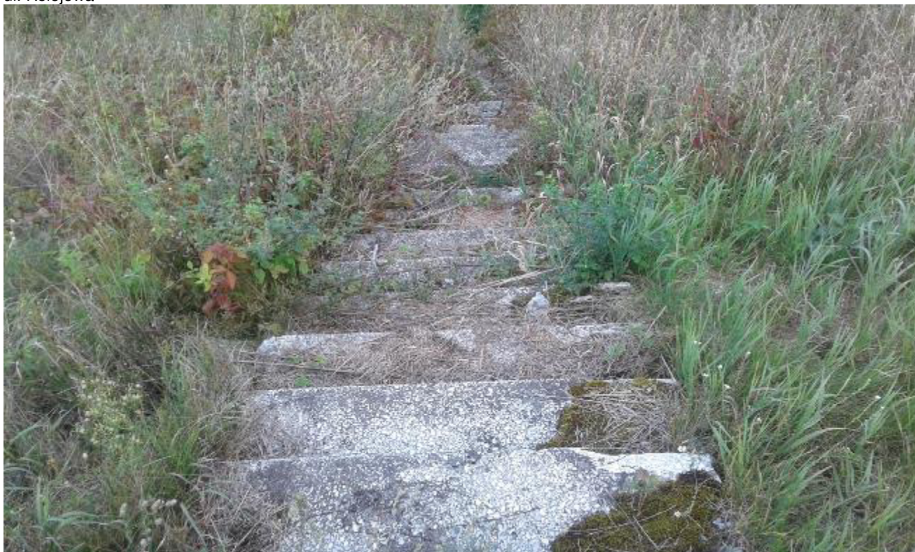
Fot. 4. Widok na schody skarpowe. Widoczne uszkodzenia i brak balustrady.
