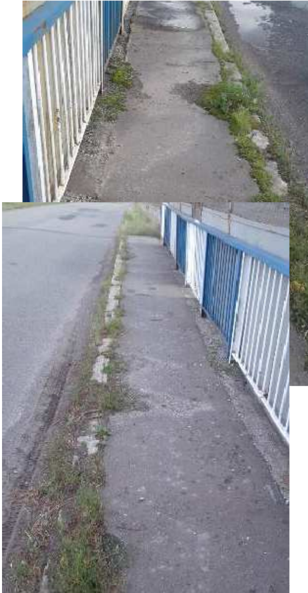
Fot. 8. Widok z góry na obiekcie. Widoczne zanieczyszczenia i chodniki
