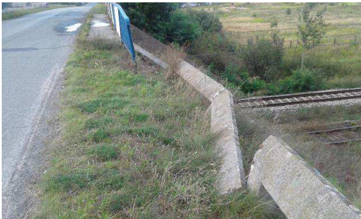
Fot.3. Widok na obiekt z poziomu drogi. Widoczne uszkodzenia nawierzchni drogowej i zniszczona bariera drogowa typu „zakopiańskiego”.
