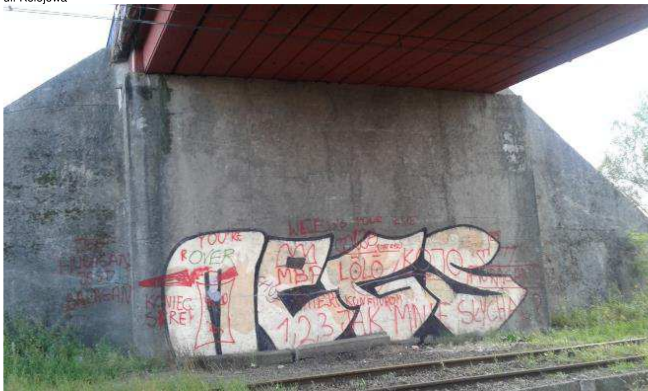
Fot. 6. Widok na przyczółek od strony miejscowości Bystrzyca. Widoczne graffiti
