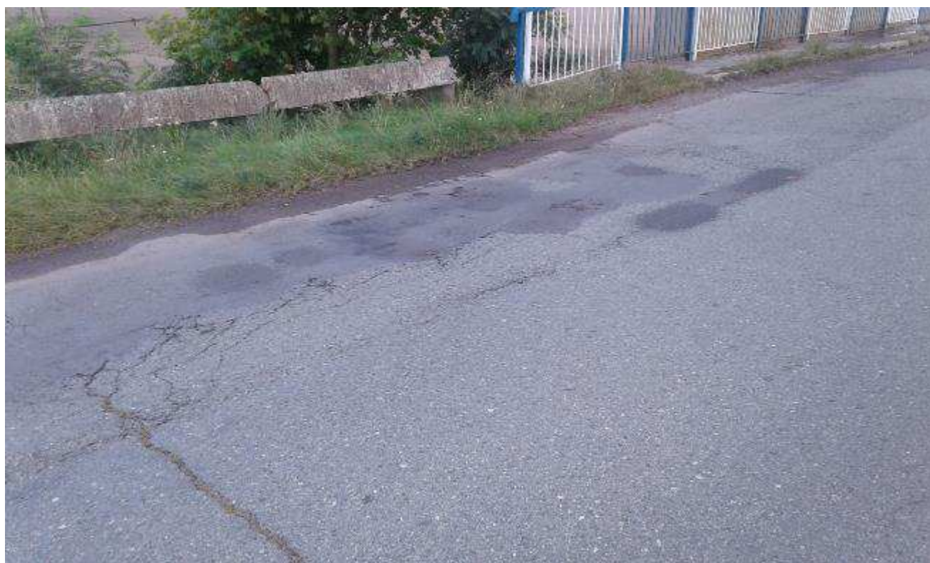
Fot. 7. Widok na jezdnię na obiekcie. Widoczne spękania i nierówności.
